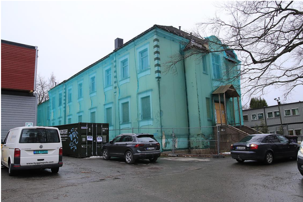
Fasade Annekset, sikret mot nedfall med duk
