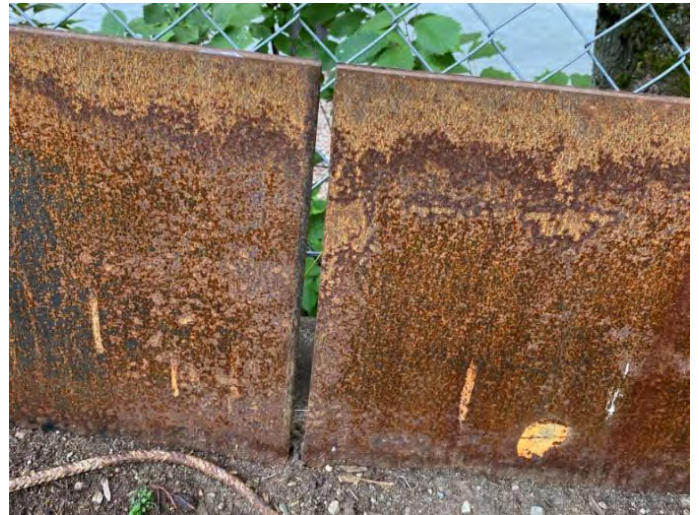
Fordrøyningsvolumet i dette regnbedet er rammet inn av plater i cortenstål. Ved anleggelse har ikke stålplatene blitt montert helt inntil hverandre. Selv om dette er en relativt liten feil, er resultatet at fordroyning på overflaten forhindres. Ved store nedbørshendelser vil vannet i stedet havne i veien og bygårdene nedstrøms regnbedet.
